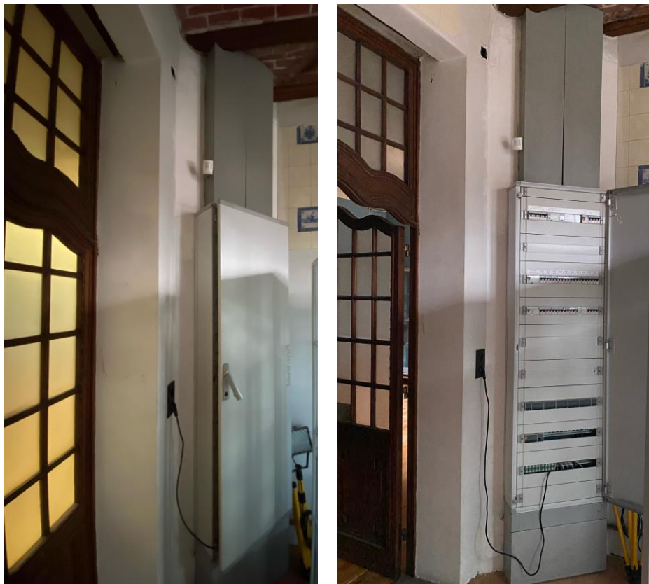
Afb. 8. Elektriciteitskast in de keuken, respectievelijk met gesloten en open deur (foto: auteur)
